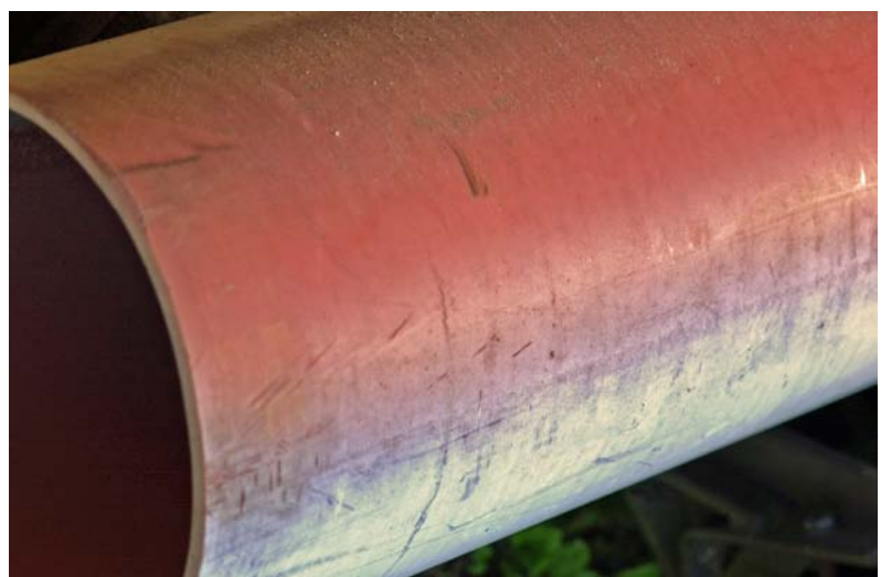
Verfärbung eines Rohres durch Einwirkung von Sonnenlicht über mehrere Jahre
